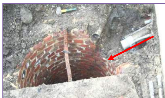
Rejet direct dans un puits d'infiltration sur le Vermandois
